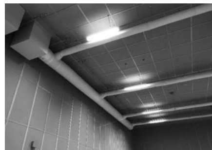
図2 収蔵庫ソックダクト空調
